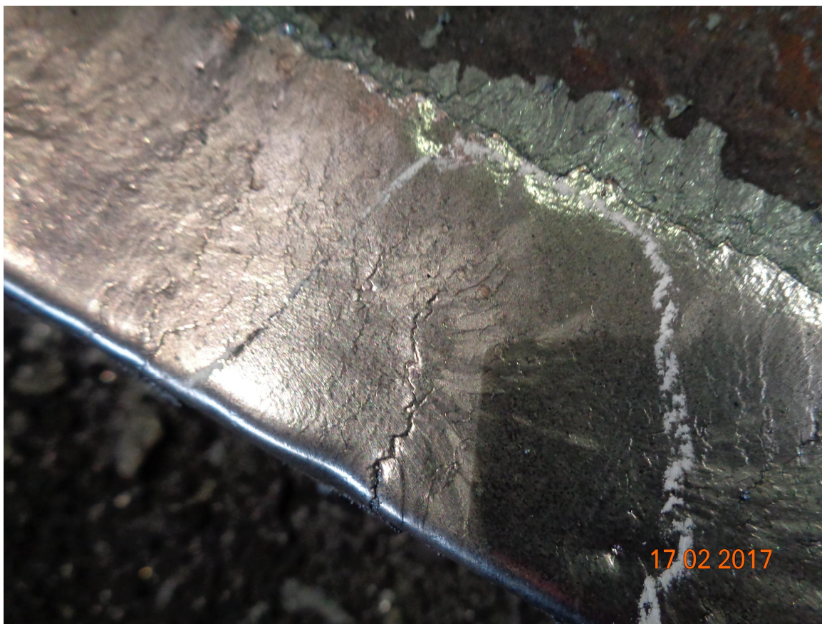
Obr. 6 Příklad pší ných rohových trhlin
