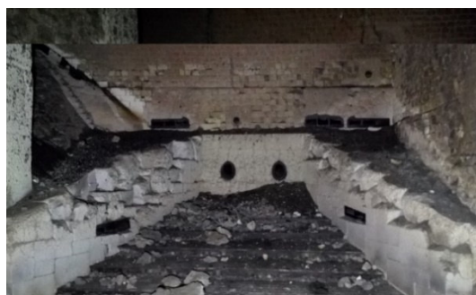
Obr. 3 První test použití vyzdívky lávek z prefabrikátů (NOVOBET 1600-AZR-SIC) - na horním snímku je nově instalovaná vyzdívka v únoru 2017, na dolním snímku stejná část vyzdívky po 6 měsících provozu v říjnu 2017
