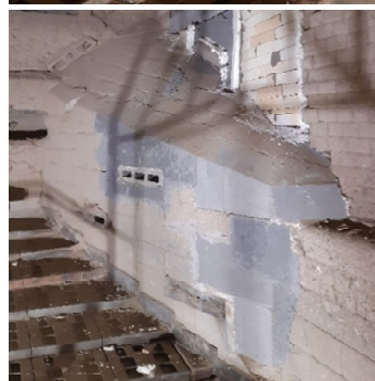
Obr. 6 Stav vyzdívky lávek po jednom roce provozu v únoru 2022 (vlevo) a po provedené garanční opravě (vpravo)
