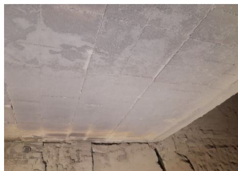
Obr. 10 Zavěšený strop ze žárobetonových tvarovek - na horním snímku část stropu po instalaci v únoru 2019, na dolním snímku stejná část po třech letech provozu v únoru 2022
