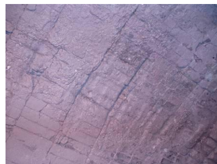
Obr. 3 Opotrebenie trvalej výmurovky 10. a 2. hodina
